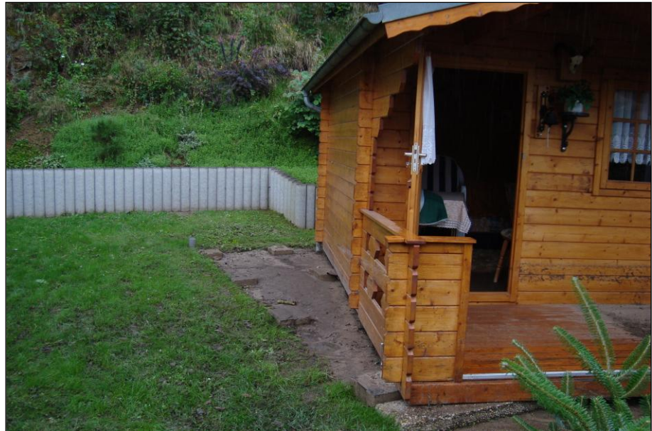
Abb. 37: Aus der Verankerung gerissenes Gartenhaus am Bachweg, 16.08.2010
